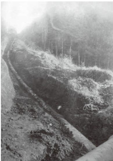
写真6 直線に付設されてあった 鉄管が大きく「カーブ」したもの (藤沢町大坂山)
