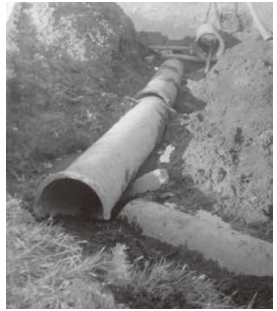
写真7 鉄管が大きく移動したもの (藤沢町大坂山)
