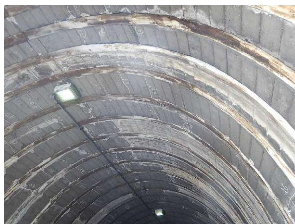
トンネルアーチ部の照明施設(村岡トンネル)
