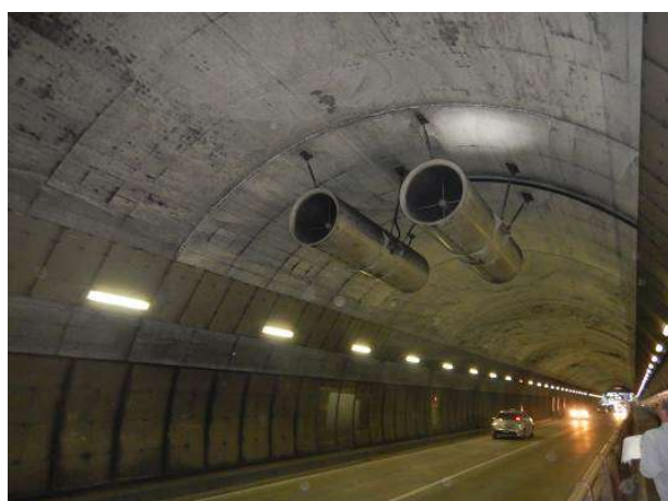
トンネル内に設置された換気施設(大庭トンネル)
