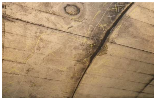
浮き状況(大庭トンネル)
