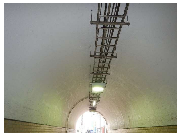
トンネルアーチ部の照明施設(村岡人道トンネル)
