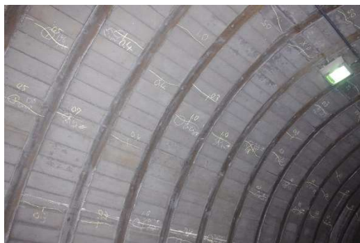
ひび割れ状況(村岡トンネル)
