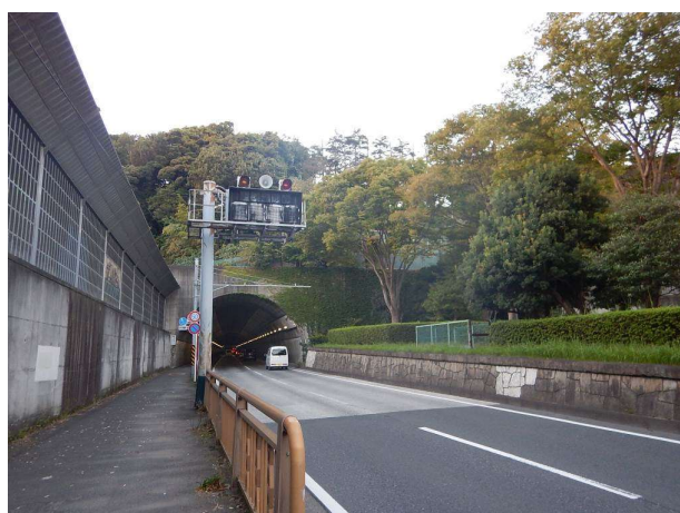
トンネル坑口に設置された非常用施設(大庭トンネル)
