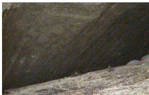
覆工背面の空洞状況(村岡人道トンネル)
