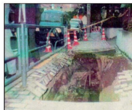
道路陥没の例 (東京都港区) (国土交通省資料)
