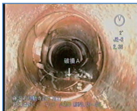
下水道管路の破損の例 (藤沢市)
