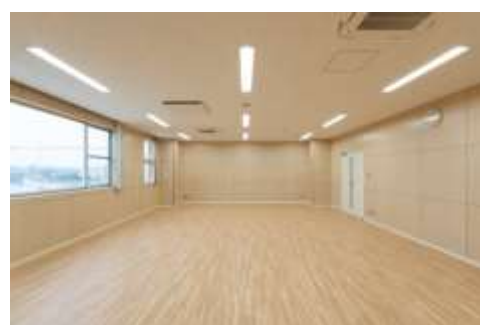
【環境事業センターに 導入した LED 照明】
