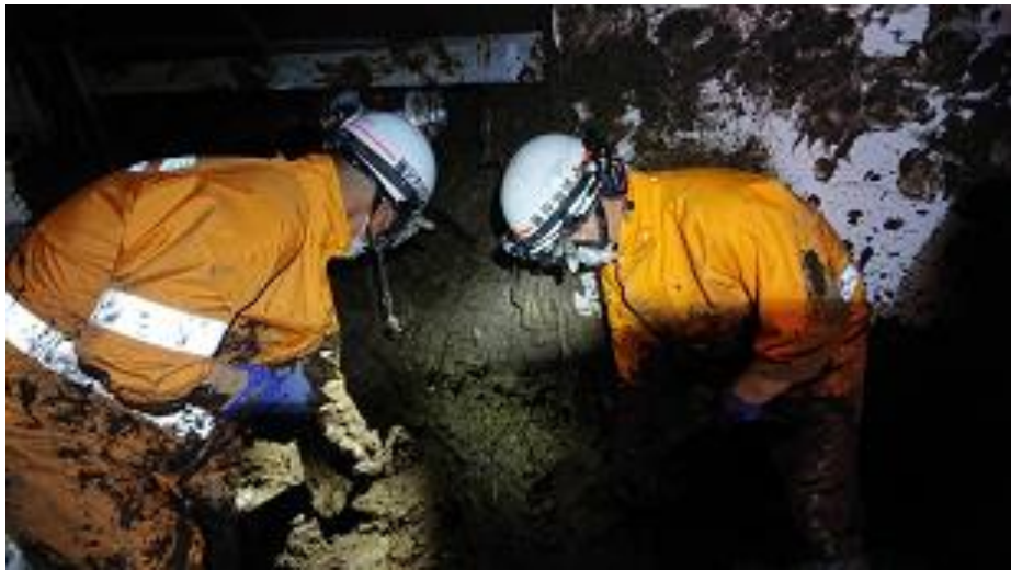
土石流に巻き込まれた家屋内での様子
