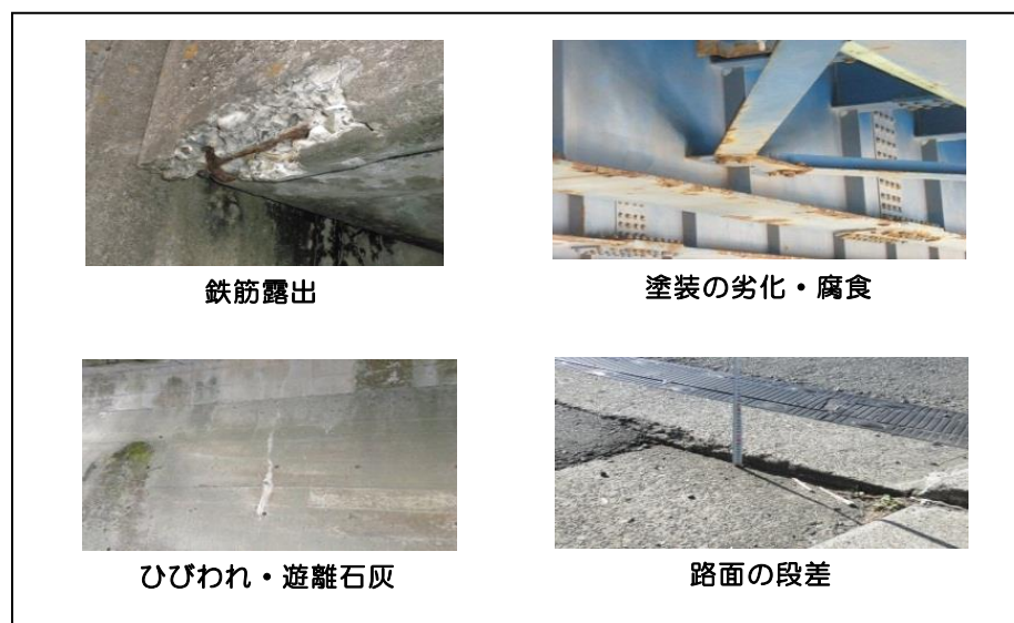
図 4 - 5 橋りょうの損傷例
