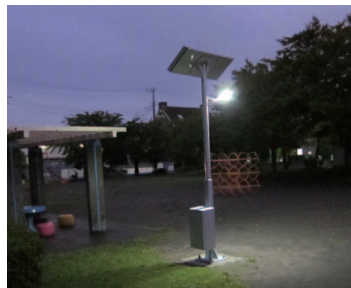
防犯と災害対策を兼ねたソーラー付LED公園照明灯の設置
