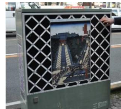
ラッピングされたトランスボックス (藤沢地区)(広報ふじさわより)
